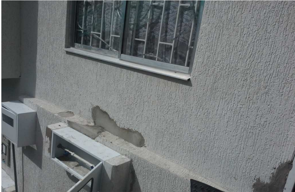
Foto No. 6 Rincón de Bolonia de la constructora CG constructores S.A.S Falta de medidores de energía y agua.
